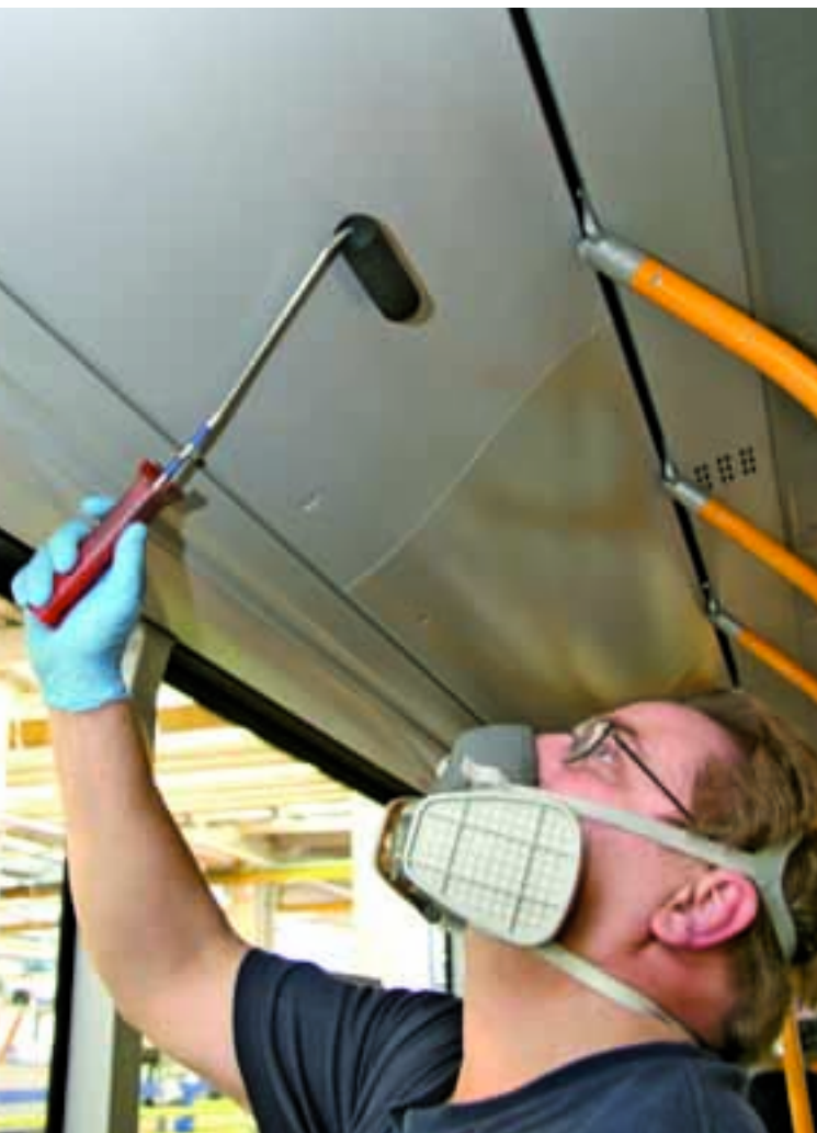
Zum Vergleich: Unter der Rolle eine bereits grundgereinigte Fläche, die mit dem Schutzlack überzogen wird. Die Klappe rechts davon ist noch unbehandelt.
